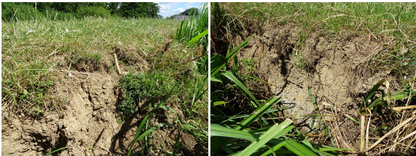
Figuur 11. In de nvo is de dijk op enkele plaatsen gedeeltelijk aan het afbrokkelen. Dit geeft kleine steile randen, die in dit geval ook nog sterk zonbeschenen zijn. Twee voorwaarden waarvan veel wilde bijen profiteren. Hier kunnen zij geschikte nestelgelegenheden vinden, zoals bleek uit de aanwezigheid van diverse grasbijen die in deze oevers nestelen. Nestgangen zijn in de regel niet dieper dan 30 cm en voor de meeste soorten geldt dat het vaak om mindere afstanden gaat. Zolang dit de dijkveiligheid niet in gevaar brengt wordt aanbevolen om zulke steilranden te handhaven.
